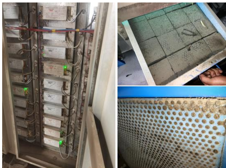
图2 光催化处理设施不正常运行（左）活性炭长期未更换（右）
