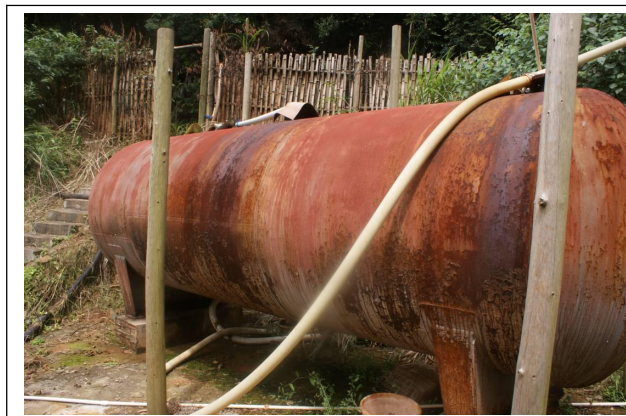
图 5.2-12 大峯围矿点遗留酸罐现状
