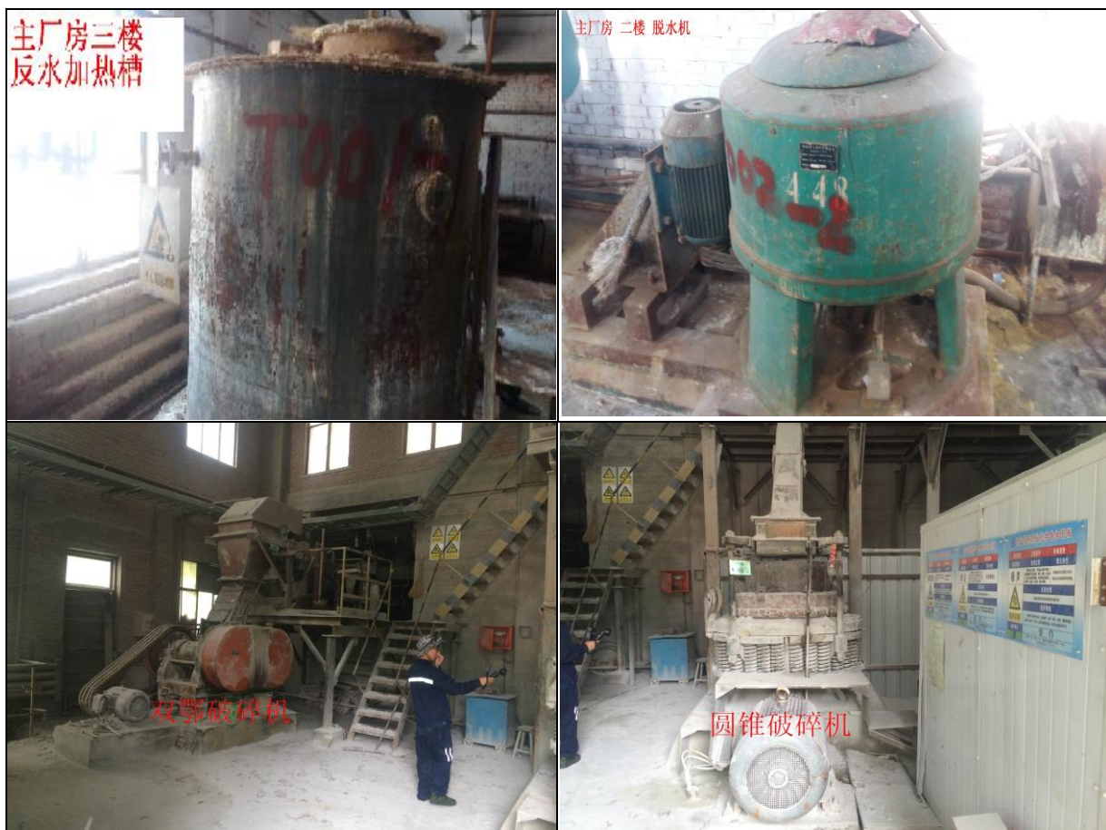
图 5.5-6 部分遗留设备现状
