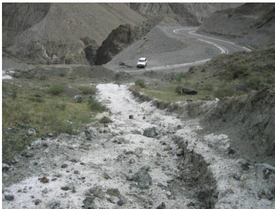
HP2 滑坡体右侧边界的拉裂缝
