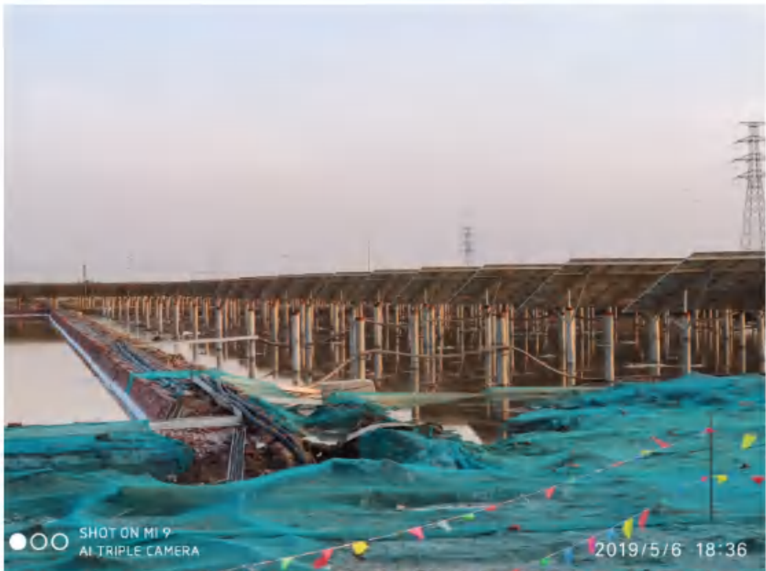
图 15.3-28 光伏发电项目已建设施
